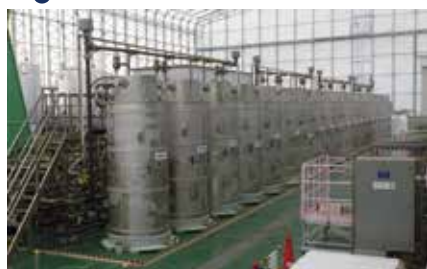
高性能多核種除去設備
