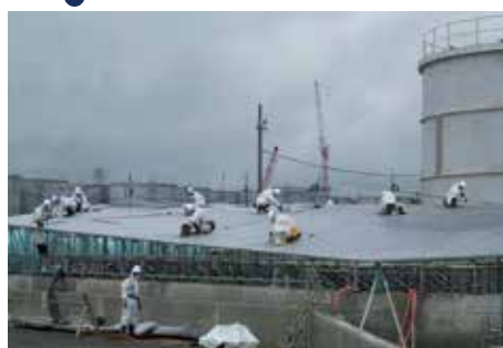
汚染水タンクエリア雨水流入防止対策
