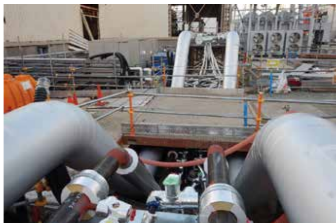
3・4号機陸側凍結管
